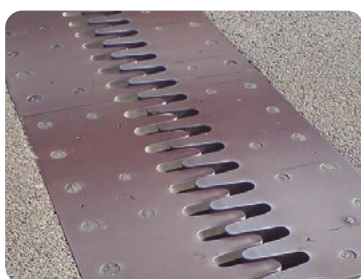
Στις γέφυρες υπάρχουν κατάλληλοι σύνδεσμοι ώστε κατά τη θερμική διαστολή ή συστολή της γέφυρας να μην προκαλείται πρόβλημα.
